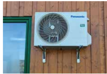
EC Teisnach Wärmepumpe
