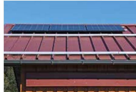
EC Teisnach Balkonkraftwerk
